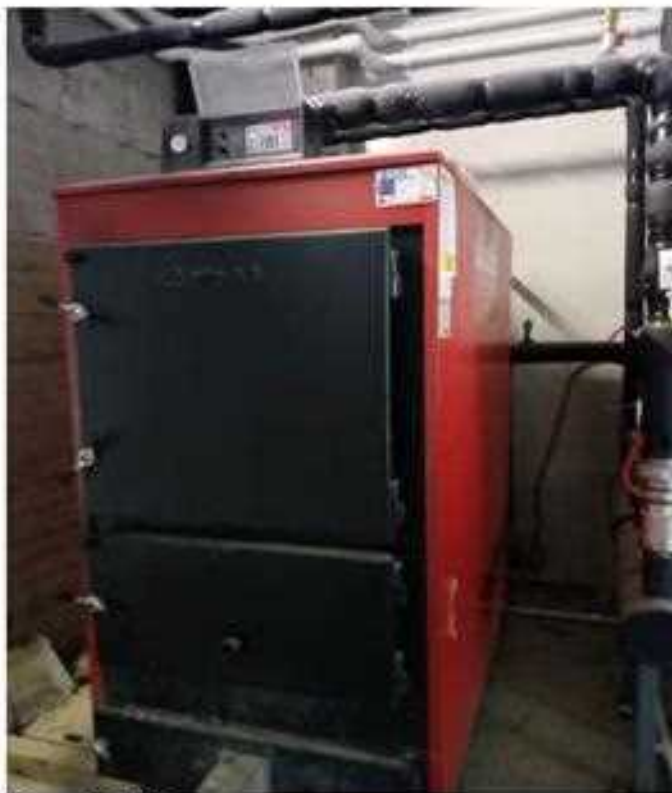
Слика бр.1 Котел на дрва
