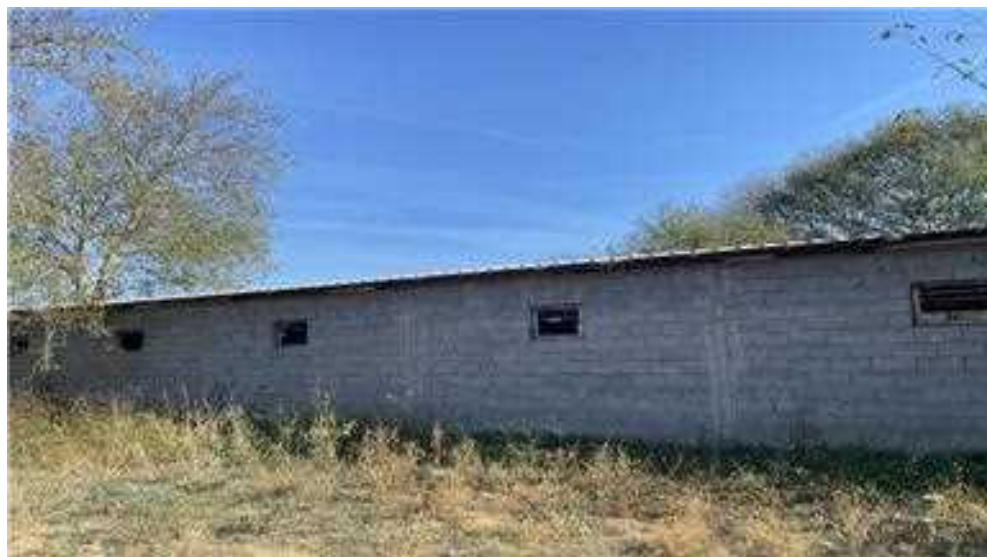
Сл.20 Отвори за дополнување на вентилацијата на објектот
